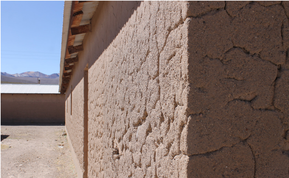
Muro de adobe estucado -y lavado por la lluvia-. Registro personal.
